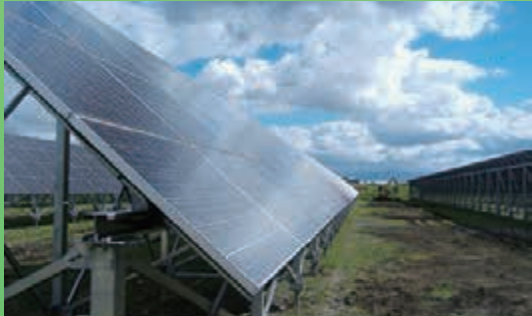
JKJ旭川ソーラー発電所
